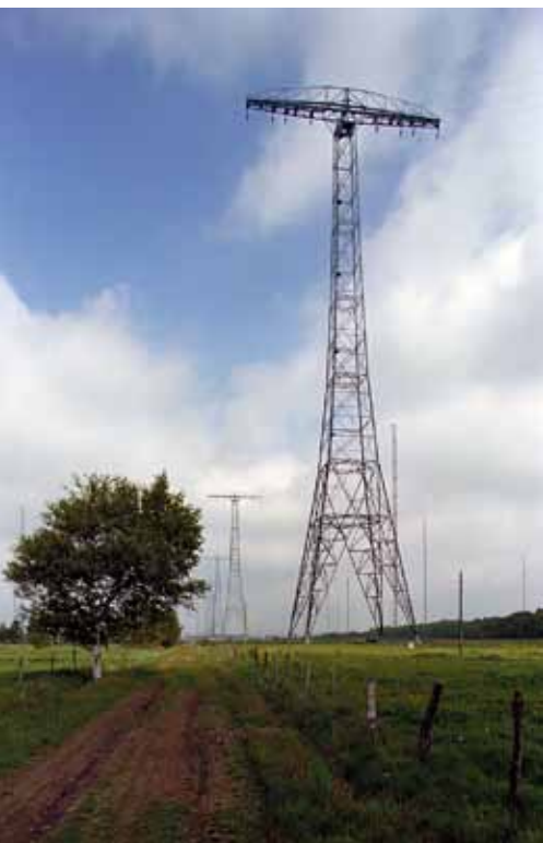
De sex ståltornen bär upp den så kallade multipelantennen.
